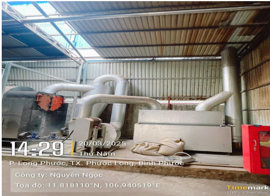
Hình 5. 1. Hệ thống xử lý khí thải lò hơi của Dự án
