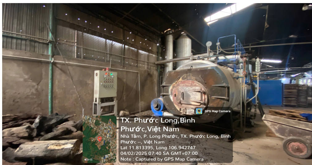
Hình 3. 5. Hình ảnh hệ thống xử lý khí thải lò hơi của Cơ sở
